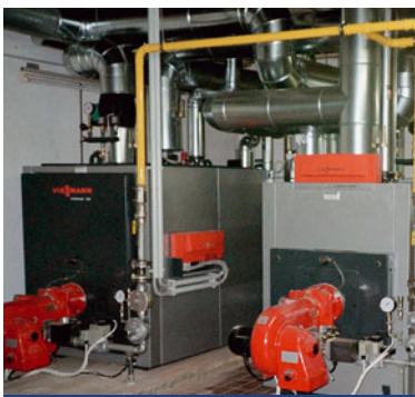
Kombination aus Brennwert- und Niedertemperatur-Gasheizkesseln in der BBS Stade
