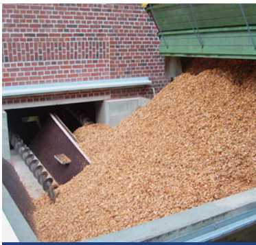
Wärmeerzeugung mit Holzhackschnitzeln an der Balthasar-Leander-Schule Harsefeld
