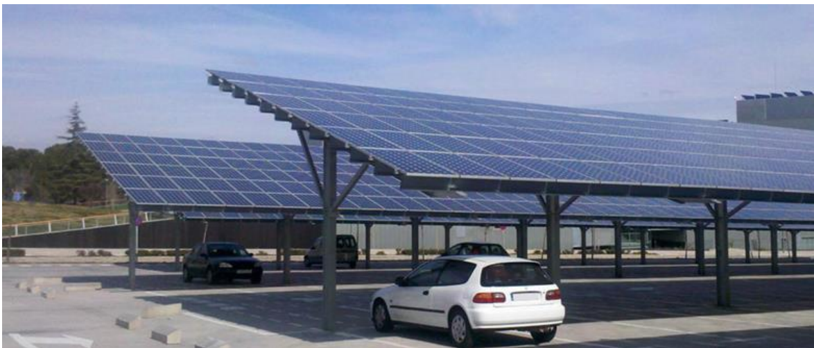
Abbildung 24: Photovoltaik-Anlage auf einem Parkplatz (Die Grünen in Lage, 2022)
